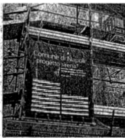
Il recupero Uno dei mille cantieri del Progetto Sirena aperti a Napoli per il restauro dei palazzi
